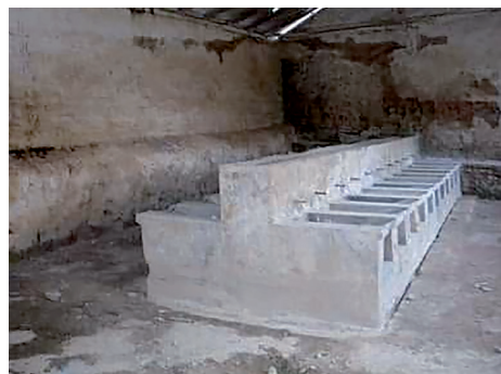
Lavadero público de Belerda, años 90 y actual infraestructura cultural en el mismo. Foto: Magdalena Avilés García
